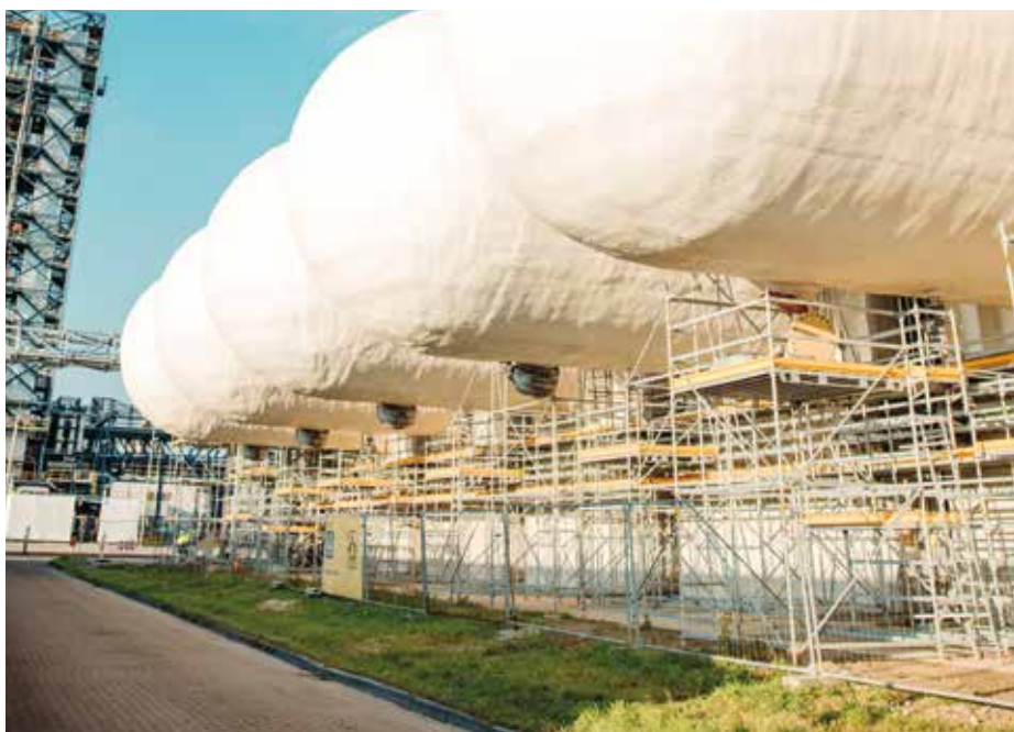
Voor het CCS-project zijn zeven enorme storagetanks gebouwd.
