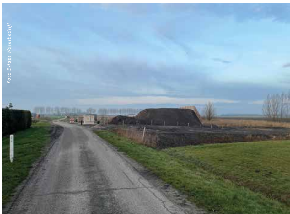
Het nieuwe pompstation Cambron in de polder van Zeeuws-Vlaanderen.
