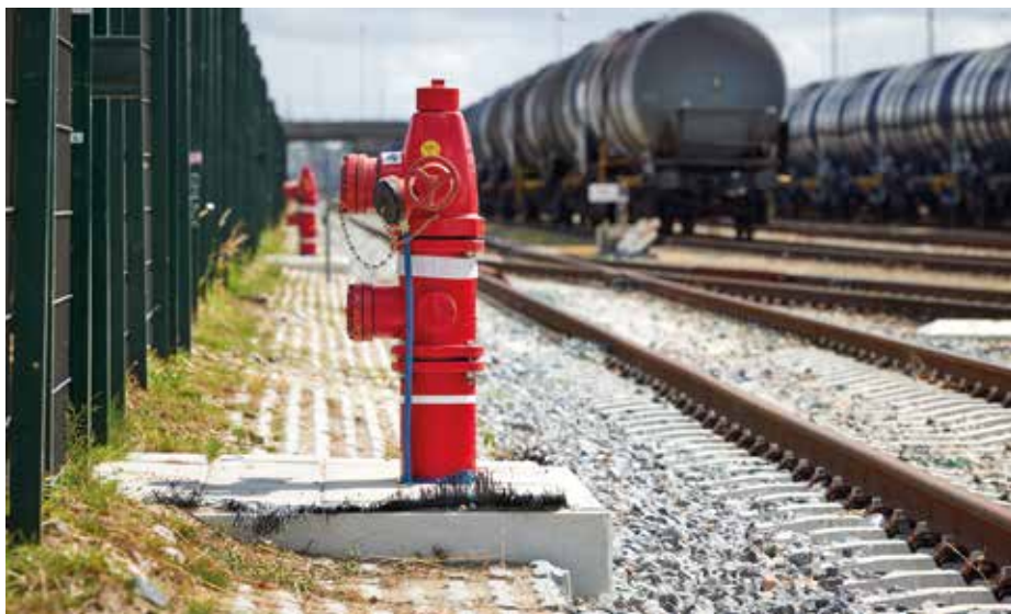
Speciaal hydrant naast Waalhaven-Zuid.
