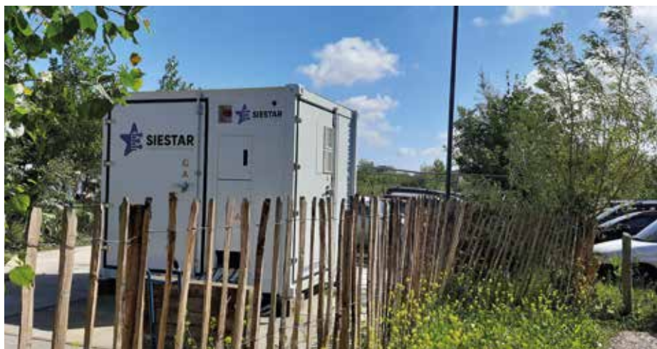
De C10 Smart Energy Storage is sinds de zomervakantie tot volle tevredenheid in gebruik op camping Ons Buiten in Oostkapelle.
