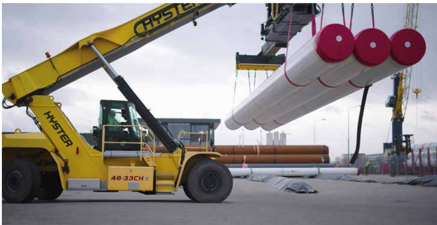
Van der Wees fungeert voor onder andere de projecten Porthos en Warmtelinq als hub voor tussentijdse op- en overslag van transportbuizen.
