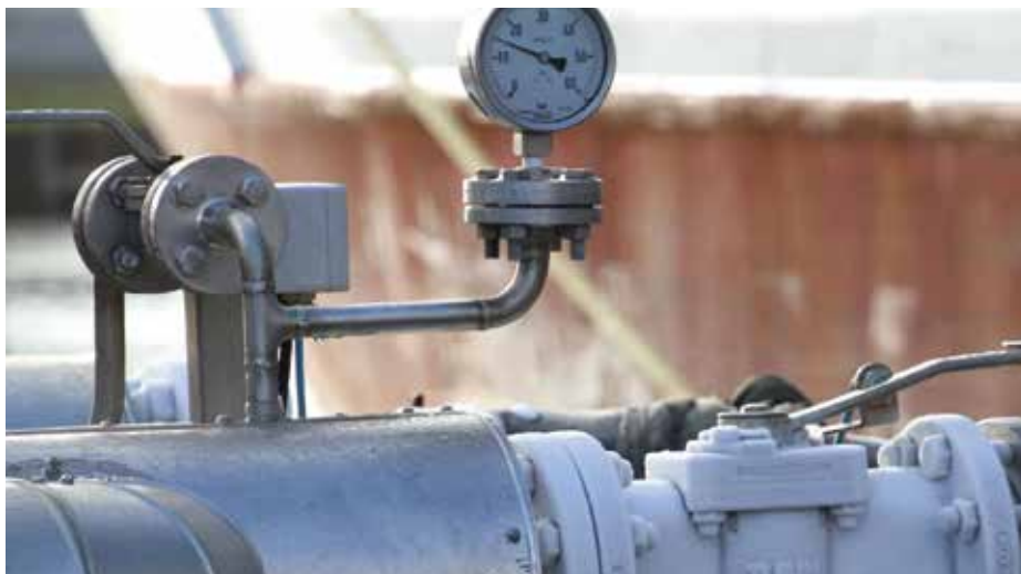
Detail van de bestaande verlaadinstallatie bij Yara Sluiskil. De koude vloeibare CO 2 wordt per schip vervoerd naar de CO 2 ontvangstinstallatie in Øygarden, gelegen aan de westkust van Noorwegen.
