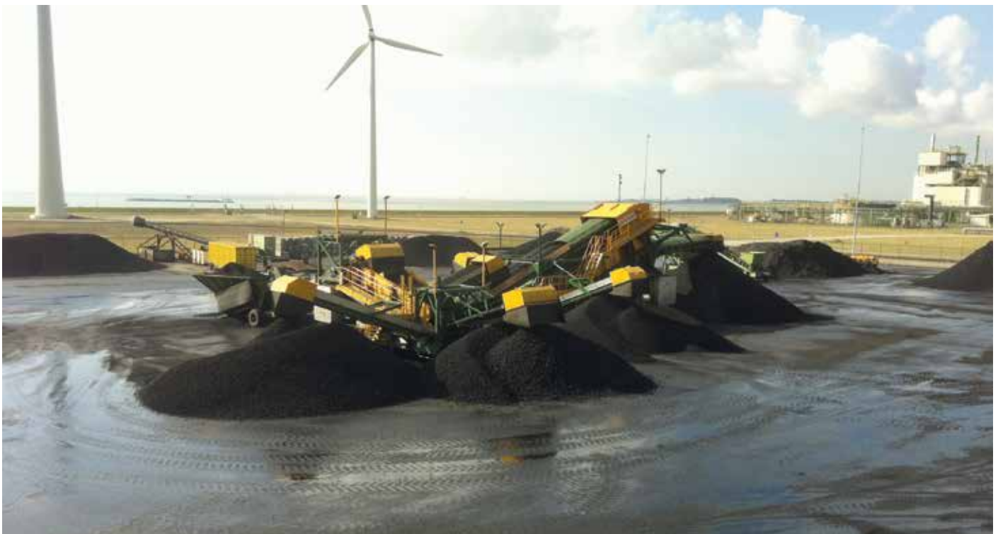
Mobiele zeefinstallatie Vlissingen.
