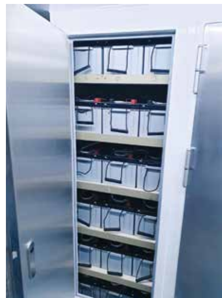
Het accupakket geeft energie voor minimaal 12 uur aan de woningvoorziening en spudpalen.
