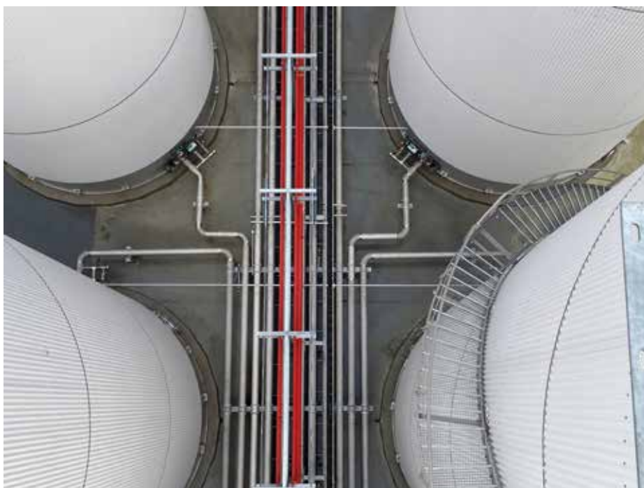
Het leidingenwerk van de nieuwe Standic-terminal wordt momenteel uitgebreid getest.
