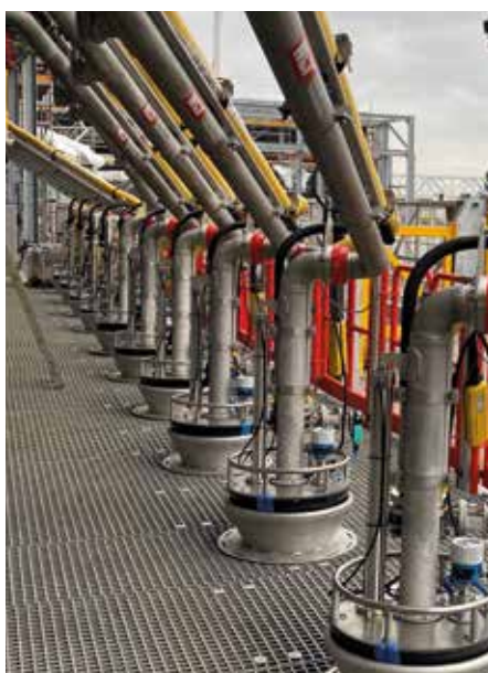
Elke tank op de nieuwe terminal is voorzien van eigen leidingen en pompen.
