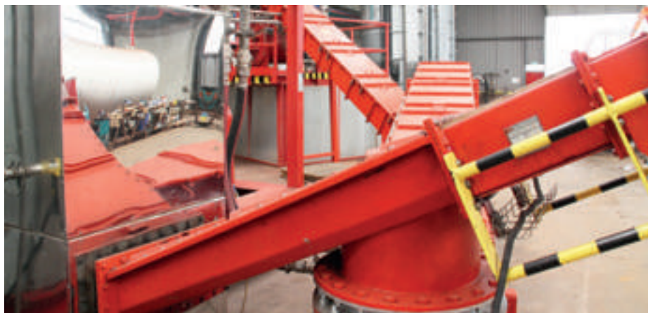
Gesloten afvoerkanaal droog destillatieresidu van een distillatie-unit voor verwerking van vloeibare oil-based-mud-vervuilde waterstromen.
