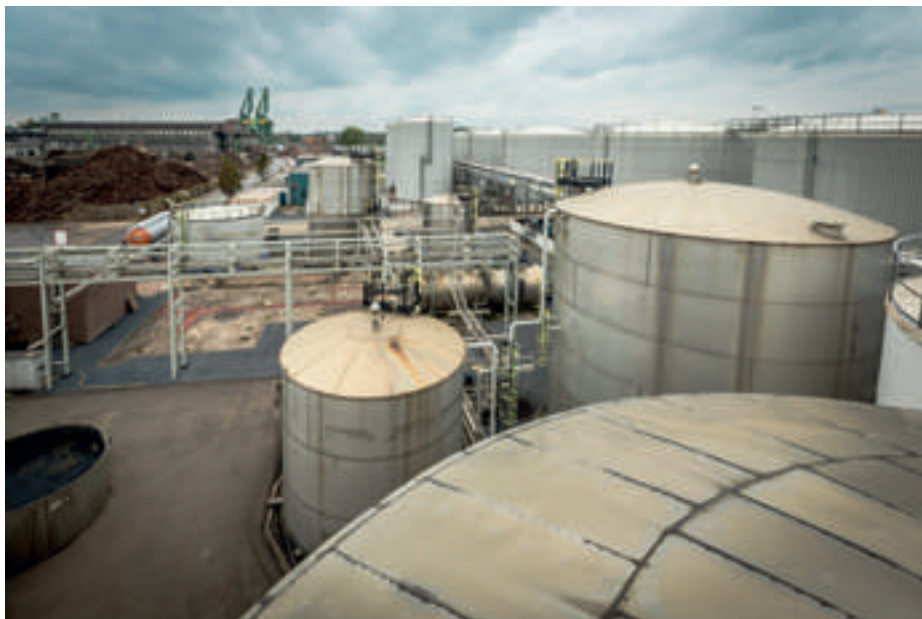
De biologische afvalwaterzuiveringsinstallatie
